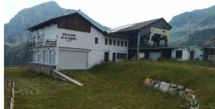
Una veduta delle condizioni di totale abbandono e fatiscenza in cui versa la seggiovia del monte Camino (foto Il Bolscevico)
