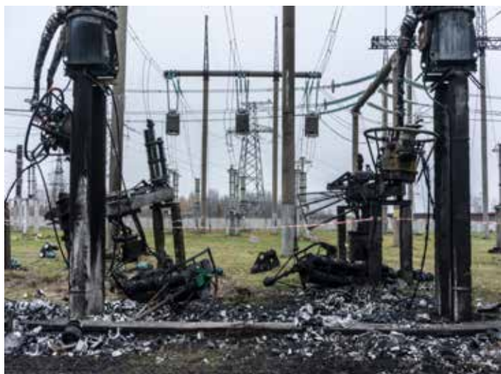
Un esempio delle distruzioni russe dei necessari servizi di energia elettrica che hanno colpito alcune città ucraine
