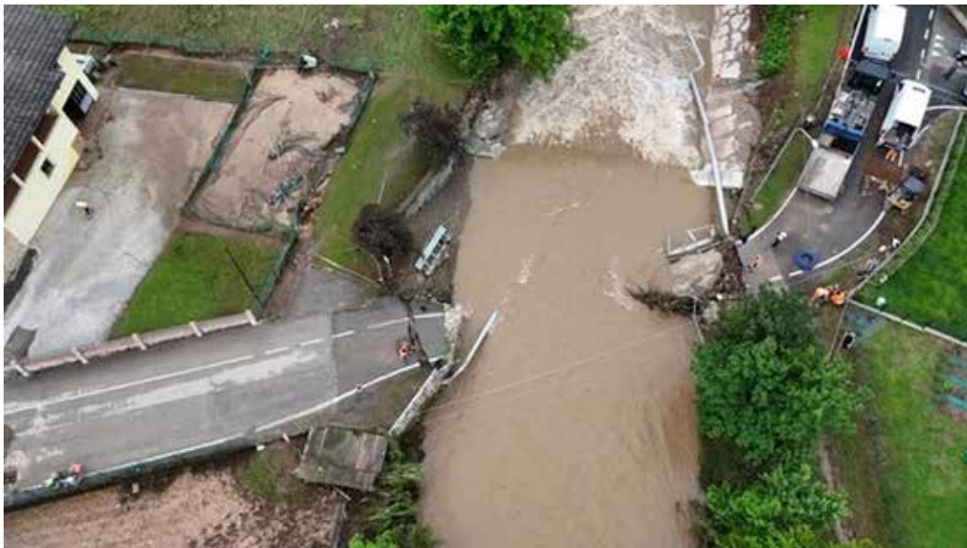
Malo (Vicenza). Il ponte travolto dalle acque del torrente Orolo
