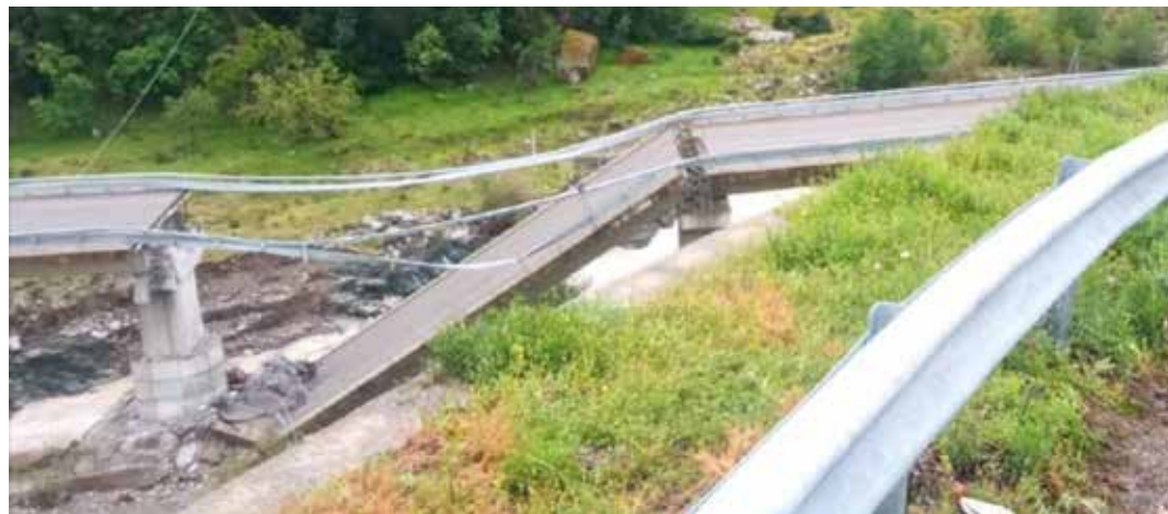
Cosenza, 3 maggio 2023. Il viadotto Ortiano 2 crollato
