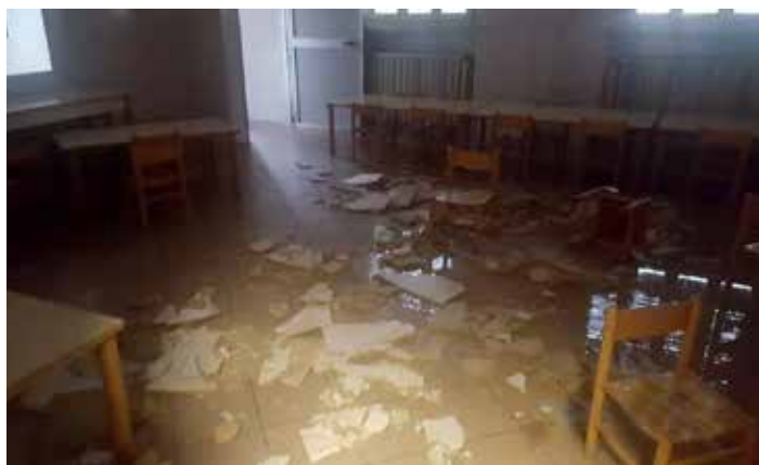
Moncalieri (Torino) crollo del controsoffitto e allagamento
