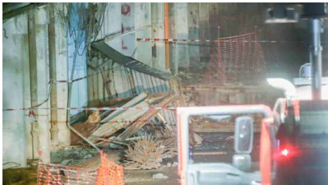
Un aspetto di quello che rimane dopo il crollo del ballatoio nella Vela di Scampia
