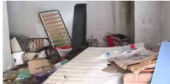
Immagine delle condizioni in cui versano gli scantinati delle case popolari
