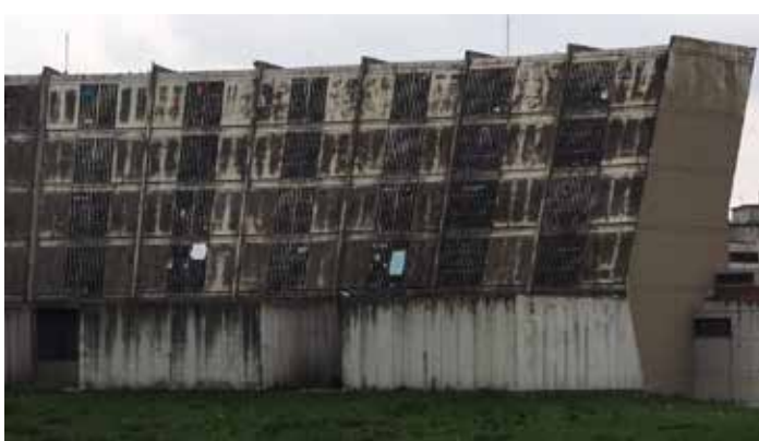
Una immagine delle condizioni fatiscenti del carcere di Sollicciano
